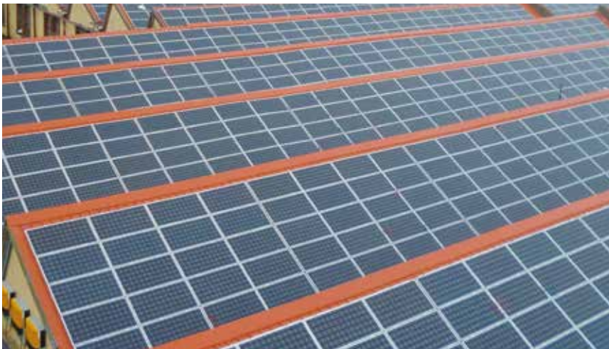
Cernay - Frankreich Anlage: 1,136 MW | SpeedRail mit AddOn
